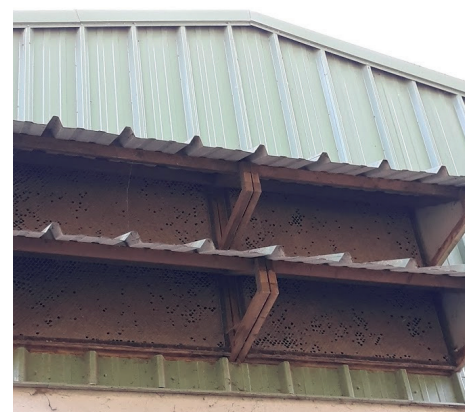
Забитая пылью поверхность защитной сетки приточных заслонок
